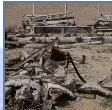
Опасность для здоровья персонала от асбестосодержащих отходов во время сноса газокompрессорной станции Опорная
